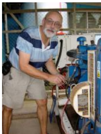
Start des Generators
